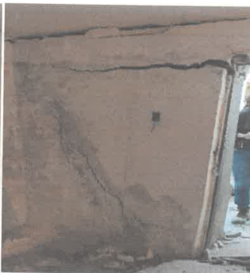
Fotografía 13. Fisuras y grietas en tabiquería.
