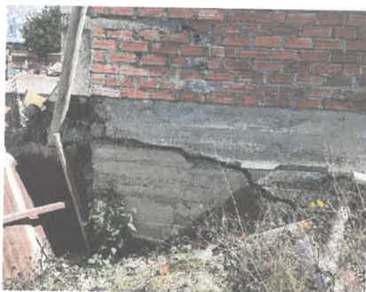
Fotografía 5. Muro lateral con grietas excesivas.
