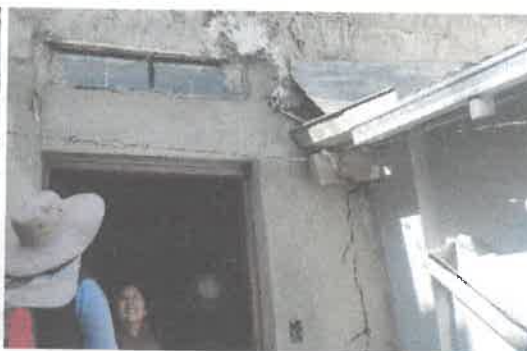
Fotografía 15. Grietas y fisuras en tabiquería.
