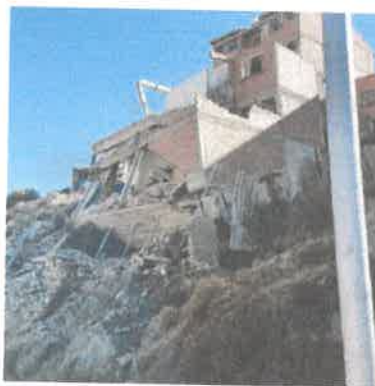
Fotografía 3. Segundo Bloque de la vivienda afectada.
