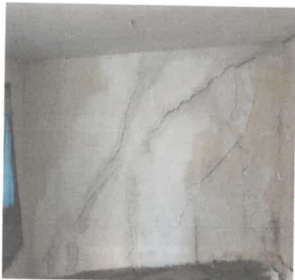
Fotografía 12. Fisuras y grietas en tabiquería.
