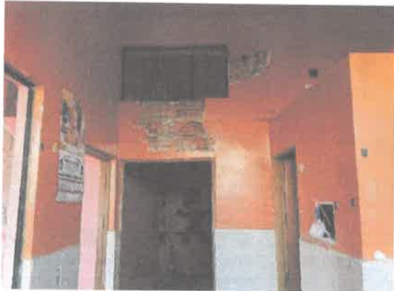
Fotografía 20. Daños severos en dintel de tabiquería de ladrillo.
