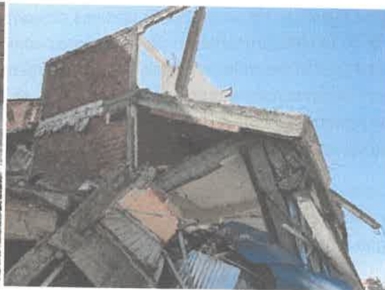
Fotografía 6. Colapso estructural parcial en el Bloque 2
