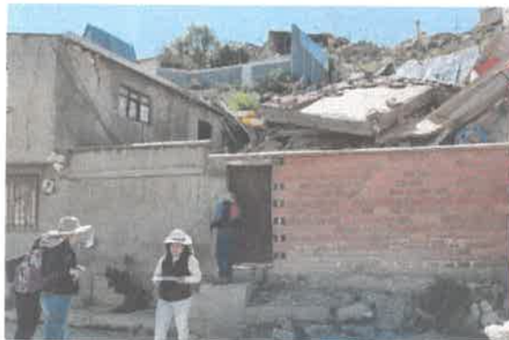
Fotografía 10. Losa de H a A o colapsada sobre el predio.
