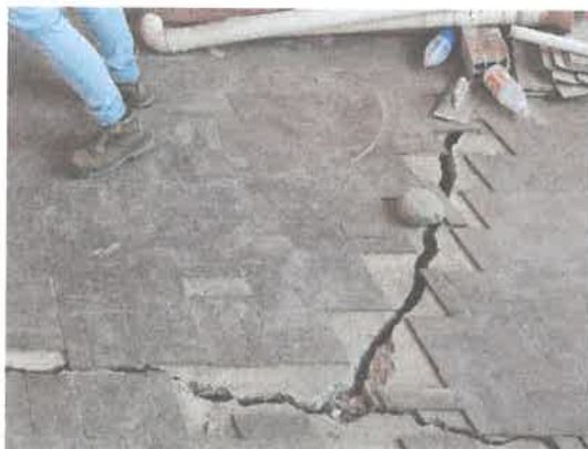
Fotografía 18. Grietas en pisos con gran apertura.
