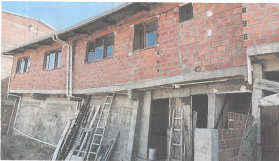
Fotografía 22. Deformación angular en losa alivianada y grietas localizadas en ventanas.
