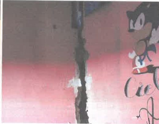
Fotografía 21. Apertura excesiva en encuentro de muro de sótano y tabiquería.
